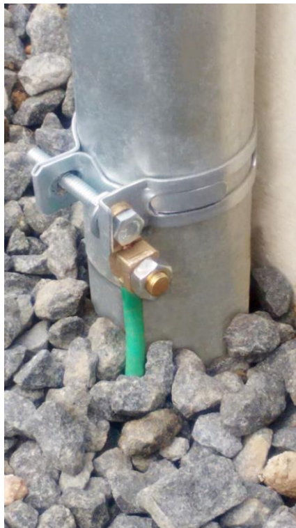
Foto ilustrativa 02 dos anexos D,E, H e I – Detalhe da abraçadeira de com terminal para aterramento
