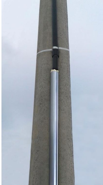
Foto ilustrativa 01 dos anexos G, H e Q – Detalhe do eletroduto junto ao poste
